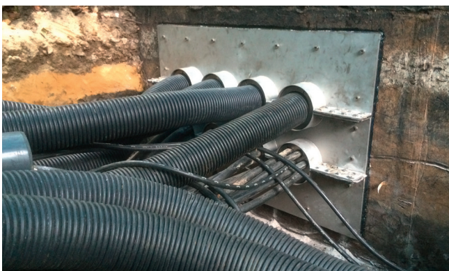
Zamontowana flansa ze stali nierdzewnej wraz z uszczelnieniem kabli i rur osłonowych.
