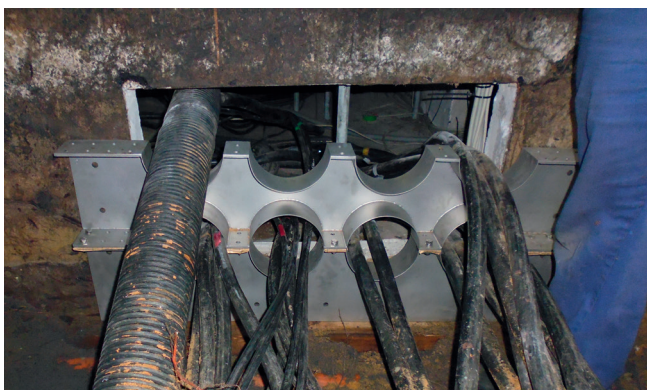
Installazione delle piastre di rinforzo premontate identificazione delle posizioni di montaggio prima del passaggio a parete.
