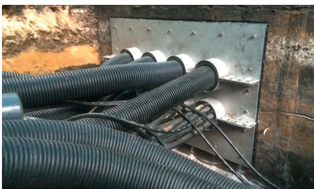
Piastra di rinforzo montata con passacavi e passatubi.
