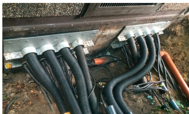
Il nuovo passaggio a parete con gli scavi per cavi e tubi di protezione prima del riempimento.
